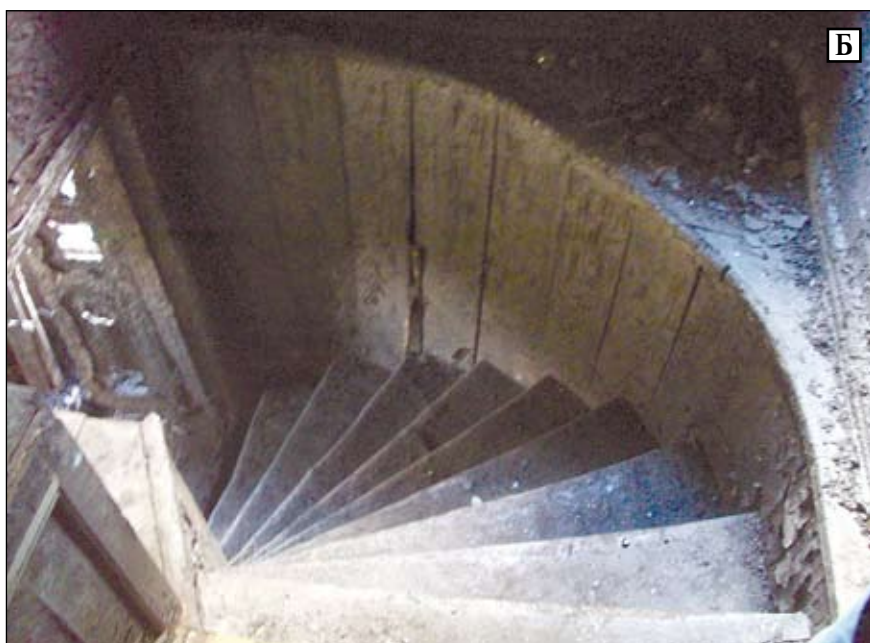
Ил. 22. Жилой дом (г. Ханты-Мансийск, ул. Кирова, д. 22). Межэтажная лестница. После пожара и после расчистки. 2014 г. Фото: О.Г. Литвинова
