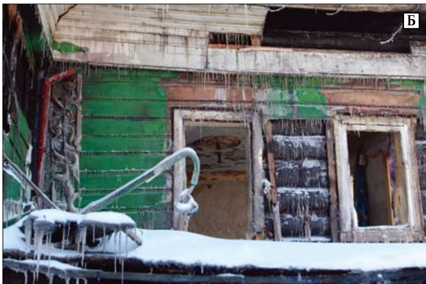
Ил. 17. Жилой дом (г. Ханты-Мансийск, ул. Кирова, д. 22). Второй этаж южного фасада. Сразу после пожара. 2013 г. Фото: Д.О. Стародумов
