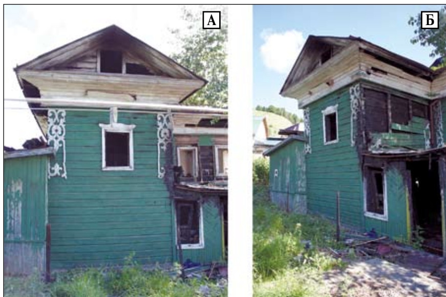
Ил. 15. Жилой дом (г. Ханты-Мансийск, ул. Кирова, д. 22). Прируб западного фасада. После пожара. 2014 г. Фото: Г.И. Мониц
