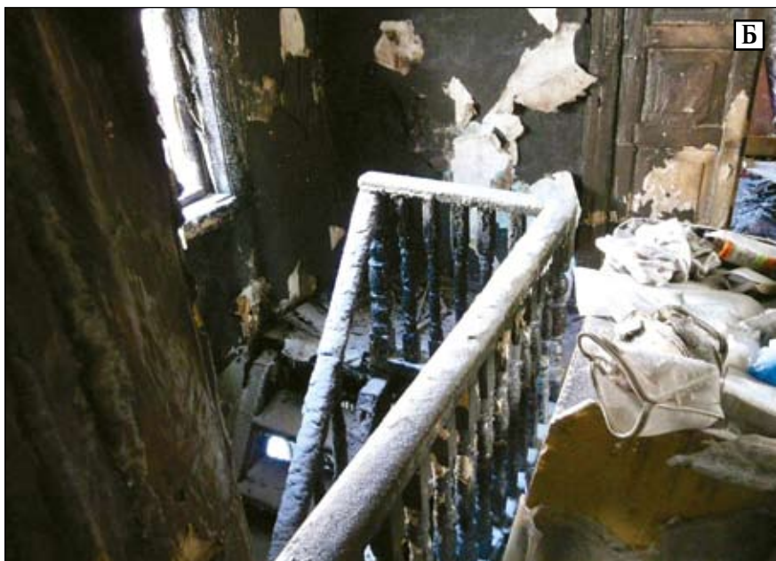
Ил. 21. Жилой дом (г. Ханты-Мансийск, ул. Кирова, д. 22). Межэтажная лестница. Сразу после пожара. 2013 г. Фото: Д.О. Стародумов
