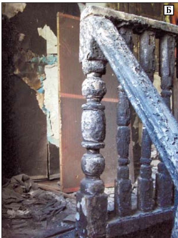
Ил. 23. Жилой дом (г. Ханты-Мансийск, ул. Кирова, д. 22). Балясины межэтаж- ной лестницы. По- сле пожара. 2014 г. Фото: Г.И. Мониц
