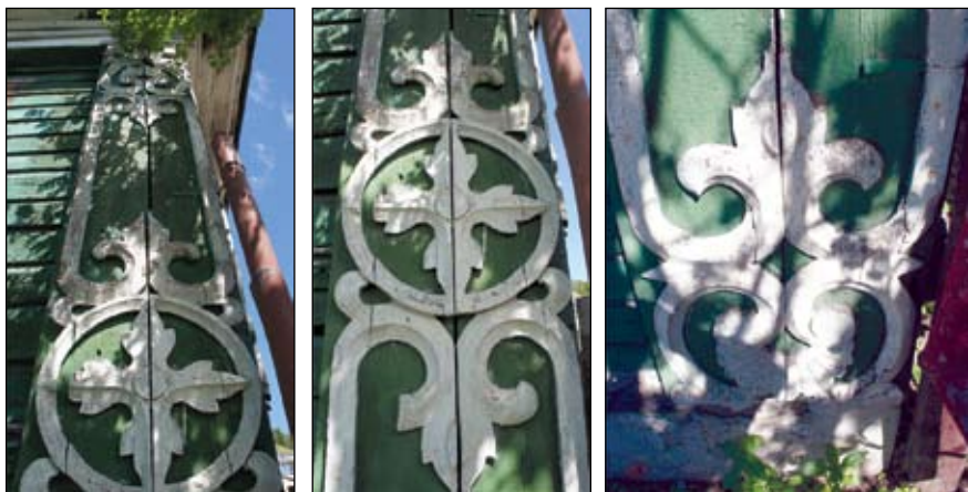
Ил. 25. Жилой дом (г. Ханты-Мансийск, ул. Кирова, д. 22). Южный фасад. Декоративная отделка пилястров в технике рельефно моделированной накладной резьбы. После пожара. 2014 г. Фото: Г.И. Мониц
