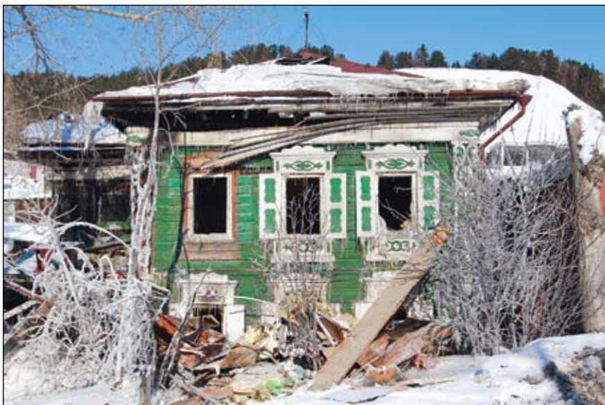
Ил. 13. Жилой дом (г. Ханты-Мансийск, ул. Кирова, д. 22). Южный фасад. Сразу после пожара. 2013 г. Фото: Д.О. Стародумов
