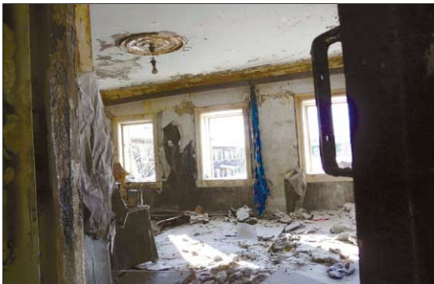
Ил. 19. Жилой дом (г. Ханты-Мансийск, ул. Кирова, д. 22). Второй этаж. Интерьер. Сразу после пожара. 2013 г. Фото: Д.О. Стародумов
