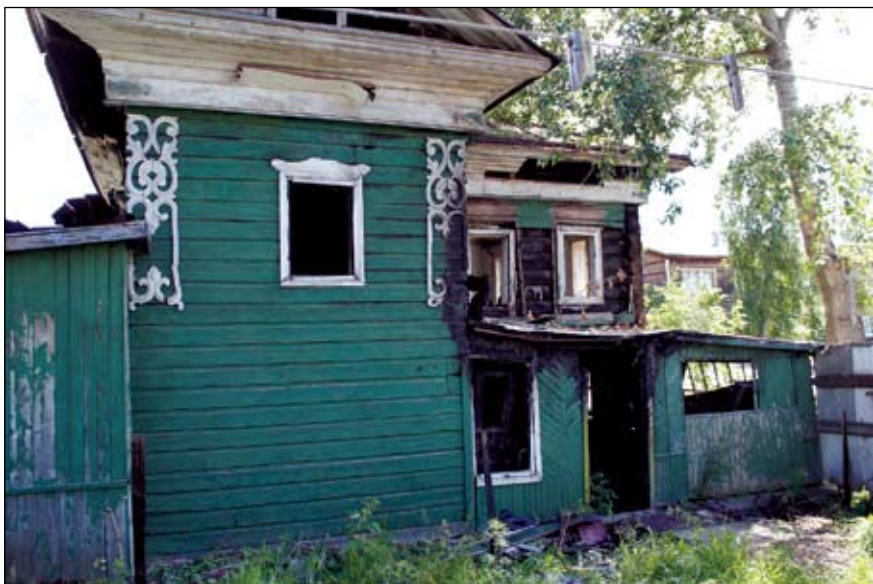
Ил. 14. Жилой дом (г. Ханты-Мансийск, ул. Кирова, д. 22). Западный фасад. После пожара. 2014 г. Фото: Г.И. Монич
